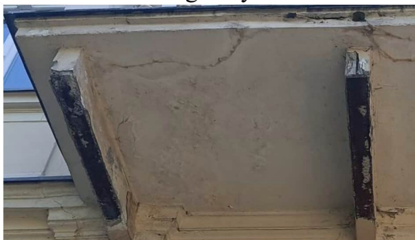
KOROZJA POWIERZCHNIOWA BELEK STALOWYCH USZKODZENIA OSZPAŁDOWANIA, UBYTKI TYNKU, ZALANIE PŁASZCZYZNY SPONIEJ BALKONU
