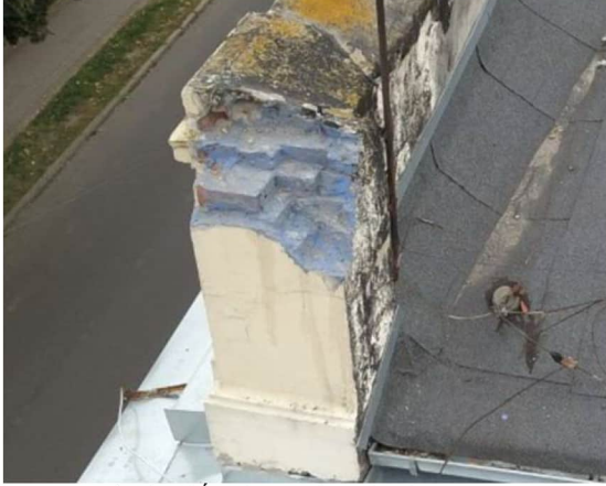
UBYTKI CEGŁY ŚCIANKI ATTYKI
