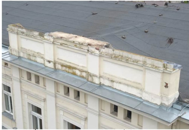
ATTYKA ŚROGKOWA PO DEMONTAŻU ELEMENTU W OSI ŚRODKOWEJ
