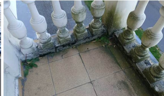
BRAK ODPLYWU WODY Z PŁYTY BALKONOWEJ
