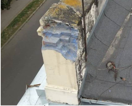
UBYTKI CEGŁY ŚCIANKI ATTYKI
