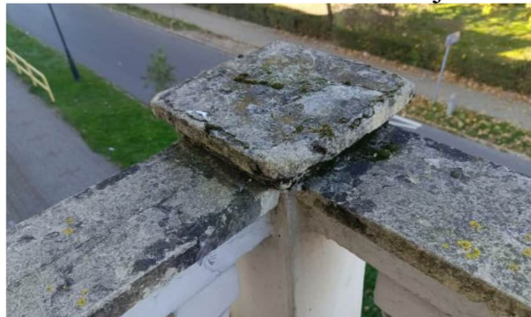
USZKODZENIA BALUSTRADY BETONOWEJ
