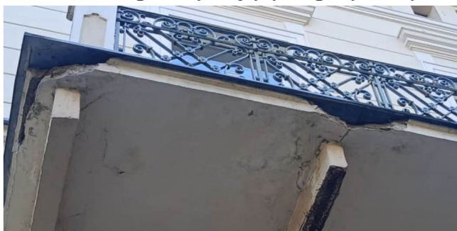
UBYTKI KRAWĘDZI PŁYT BALKONOWYCH
