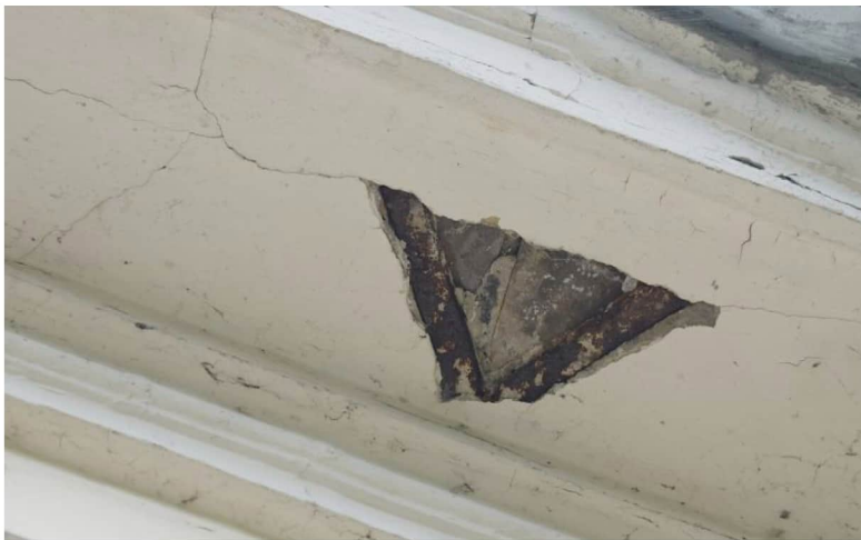
USZKODZENIA GZYMSU PODRYNNOWEGO W MIEJSCACH PRZECIEKÓW
