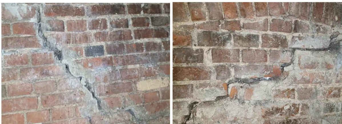
PEKNIĘCIA ŚCIANY FUNDAMENTOWEJ PIWNIC ŁĄCZNIKA
