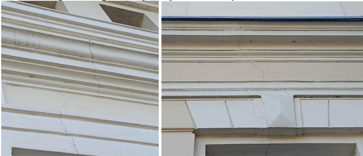
PRZYKŁADOWE RYSY NA ELEWACJI ŚCIANY FRONTOWEJ
