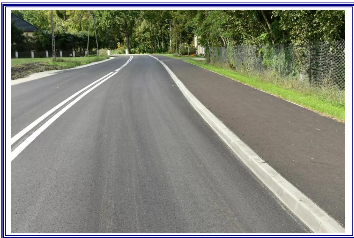
Przebudowa drogi powiatowej nr 2608C Konradowo – Siniarzewo – etap I w miejscowości Siniarzewo, Sinki, gmina Zakrzewo
